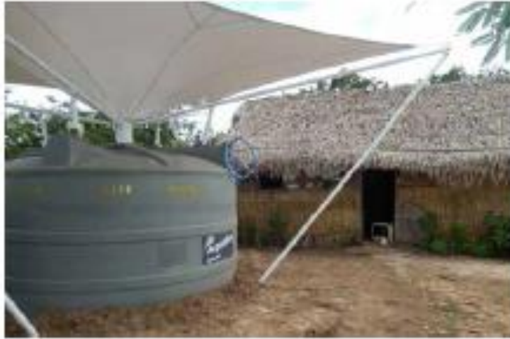
CISTERNA DE CAPTACION PROPIA
