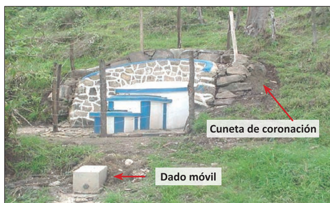
Estructura de captación y otros componentes. SAP "El Choloque", Utco, Celendín – Cajamarca.
