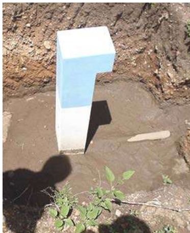
Tubo rompe carga
