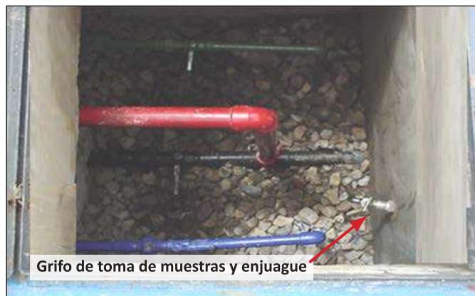
Caseta de válvulas del reservorio: Grifo de toma de muestras de agua cruda y enjuague
