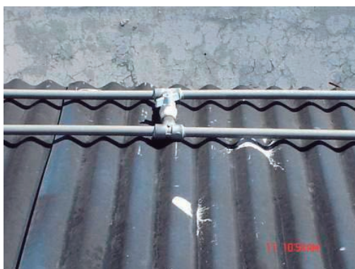
Dispositivo de distribución del agua fría
