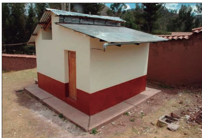
Vista panorámica del sistema instalado
