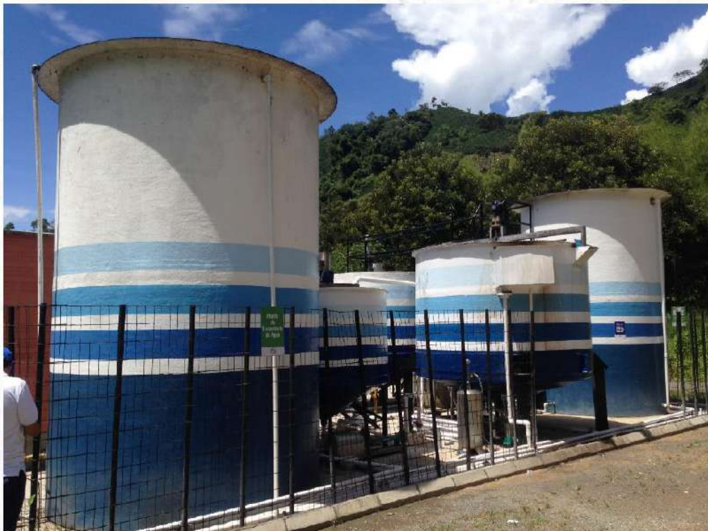
Planta de Tratamiento de Aguas en Central de Beneficio Farallones
